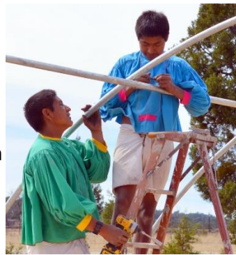
De bouw van een kas voor Enrique en Marianita. Personeel en studenten van de Tarahumaraschool nemen hier ook aan deel, zij zijn altijd bereid mee te helpen waar het nodig
